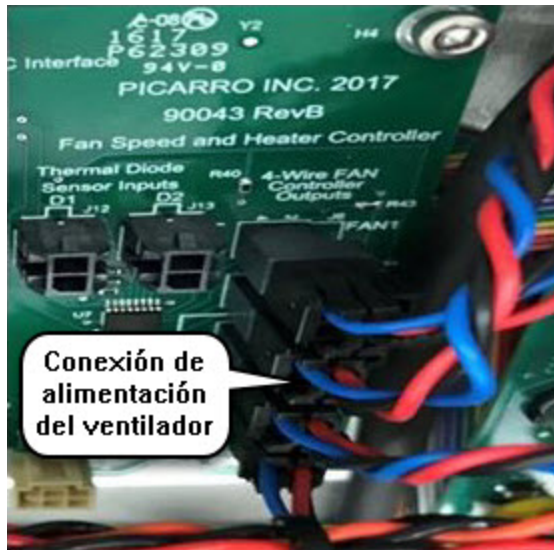
Figura 51 - Conexión de alimentación del ventilador de la caja
